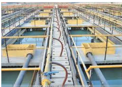
Hệ thống xử lí nước thải
